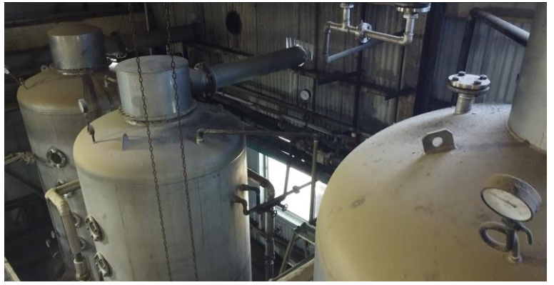
〈ドローン目線でのエキス濃縮釜上部〉
